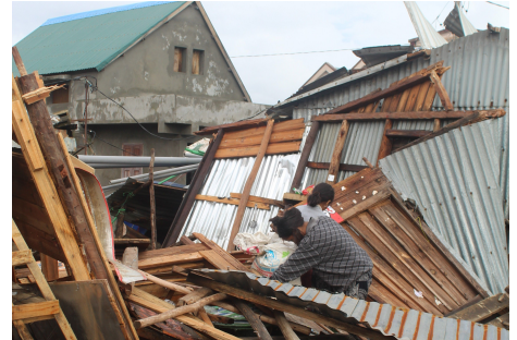
Der Zyklon Gezani hinterließ zerstörte Häuser und überflutete Wohngebiete. Viele Familien kämpfen weiterhin um den Wiederaufbau ihrer Existenz.
